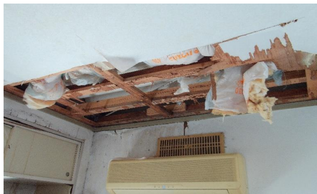
1F 台所 天井 雨漏り
